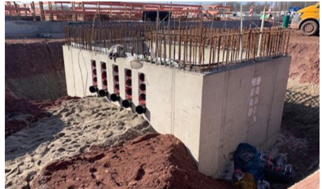
Mit den Schrägdichtpackungen HSI150 K2 S wurde eine 2,5 bar gas- und druckwasserdichte Anschlussmöglichkeit erstellt, bei der auch alle Biegeradien, der später durch das Leerrohrsystem laufenden Kabel, eingehalten werden können.
