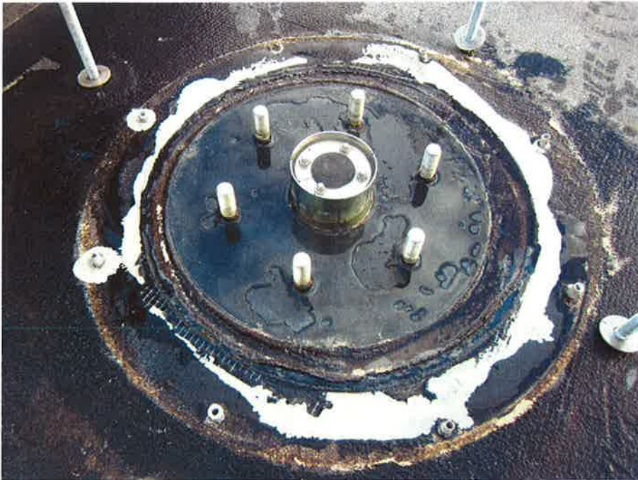
Abbildung 6: Ansicht - Versuchsaufbau nach Abnahme der Stahlplatte und der Ringdichtung
