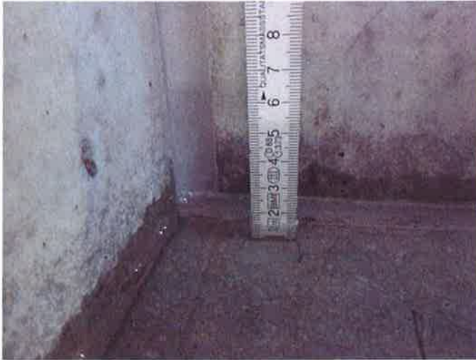
Abbildung 13: Ölstand in der Wanne unmittelbar nach dem Einbringen des Öls im Bereich der Abdichtungsfuge (ca. 15 mm)
