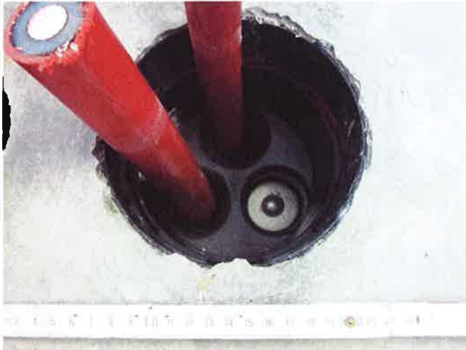
Abbildung 5: HSI 150 D3/58 mit Verschlussstopfen VS58/60, Thermo- und Kaltschrumpfmuffe in HSI 150-K 100, Betonwanneninnenseite
