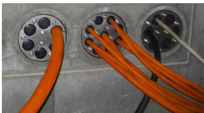
HRD150 SG intégré dans des gaines en fibrociment
