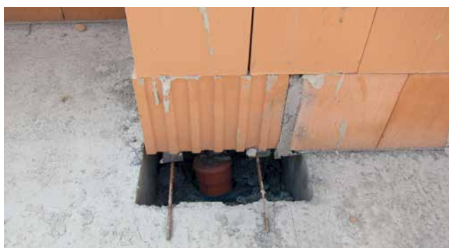
difficulté: étanchéité ultérieure au gaz et à la vapeur
