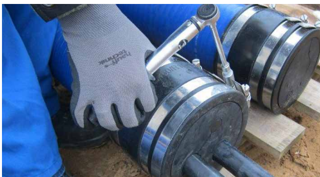
raccordement étanche à la pression du Hateflex14090 au passage étanche HSI90 et terminaison d'extrémité de gaine
