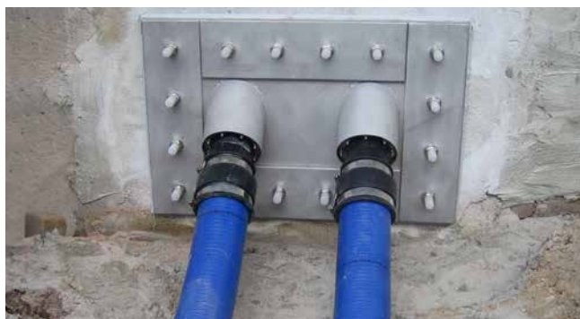
Brida fija/suelta con unión de tubería vacía inclinada antes del sellado superficial
