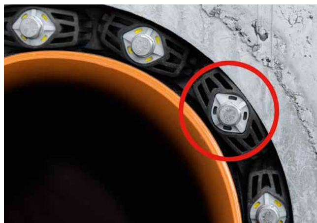
GKD con un segmento no apretado – defecto de montaje identificado inmediatamente.
