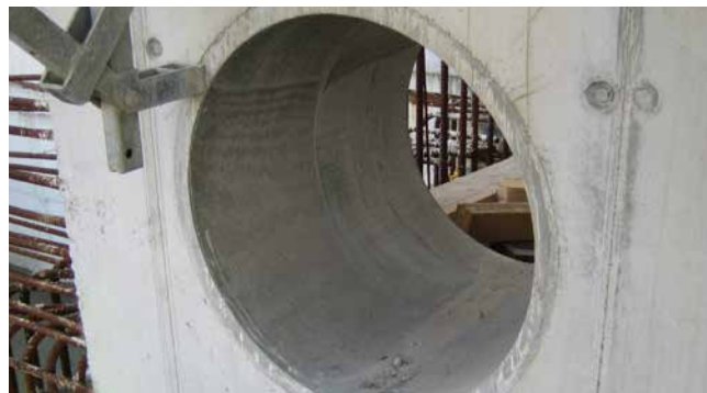
FZR400/300 Lugar de montaje de la depuradora de agua
