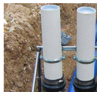
Disposición en línea 2x KES150 MA ZVR150/500 en el dispositivo de ajuste KES FUBO-FIX AV
