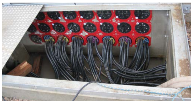
HSI 150 - uszczelnione przewody sterujące w stacji kontenerowej
