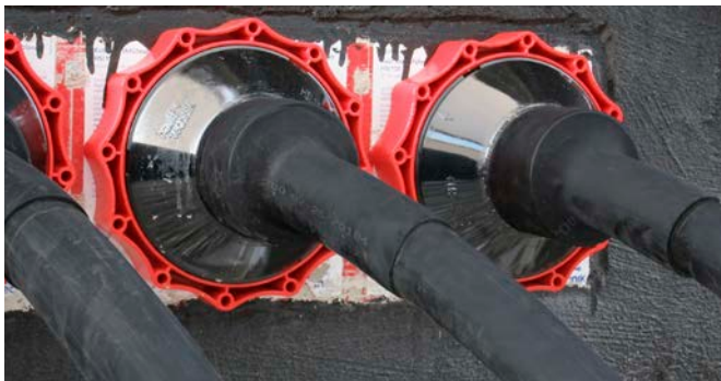
Stacja kontenerowa: kable niskiego napięcia uszczelnione pokrywami HSI 150-D1/80
