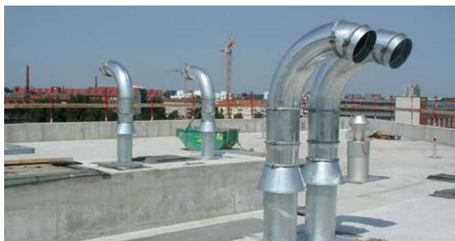
Zamontowane przepusty SHD 200, bez kabli
