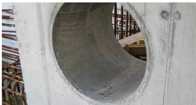
FZR400/300 Einbauort Kläranlage
