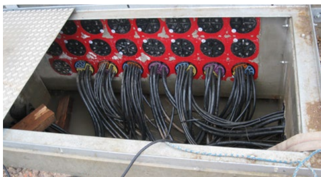
zabetonowane przepusty HSI150 wyposażone w pokrywę systemową SEGMENTO z uszczelnionymi kablami sterowniczymi
