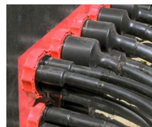
stacja kontenerowa: kable niskiego napięcia uszczelnione za pomocą
