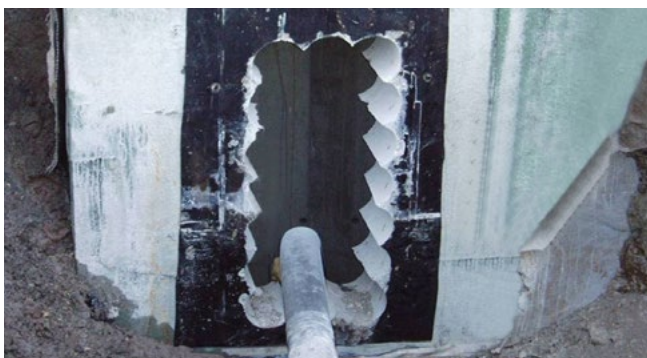
przewód wysokiego napięcia i rury osłonowe muszą zostać dodatkowo uszczelnione w ścianie szybu
