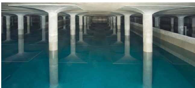
Zbiornik wody pitnej Krottenbach Quelle
