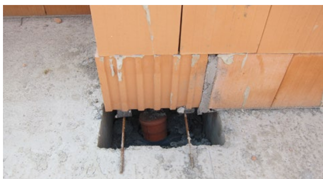
przykład niewłaściwego przygotowania wyprowadzenia pionu i wiążące się z tym trudności wykonawcze
