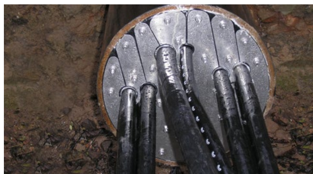
HRD200 G b30 uszczelnienie końca rury stalowej i wychodzących z niej kabli
