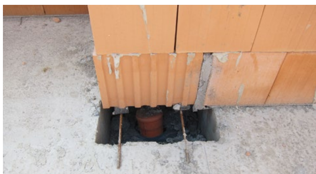
przykład niewłaściwego przygotowania wyprowadzenia pionu i wiążące się z tym trudności wykonawcze
