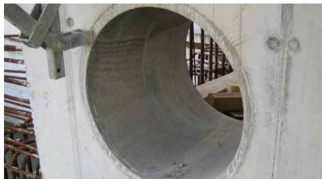
FZR400/300 Einbauort Kläranlage
