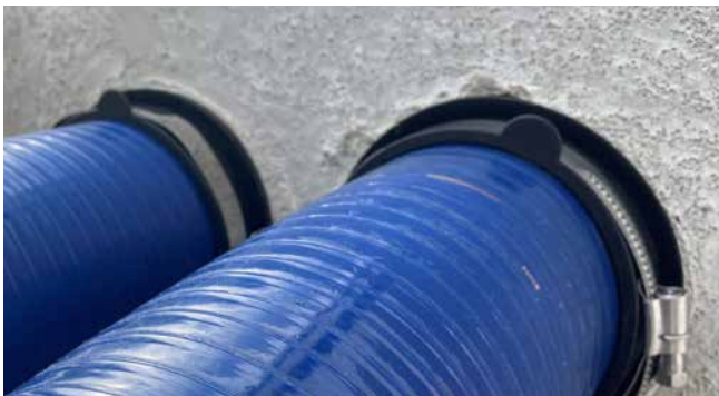
HSI150 KMA eingebaut
