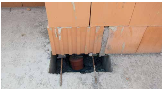
Schwierigkeit: nachträglicher gas- und dampfdichter Verschluss
