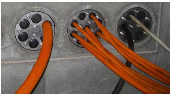
HRD150 SG eingebaut in Faserzementfutterrohre
