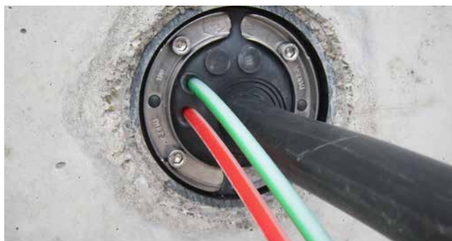
Eingebaute HSD100 EW
