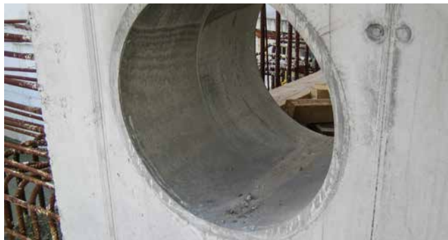
FZR400/300 Einbauort Kläranlage
