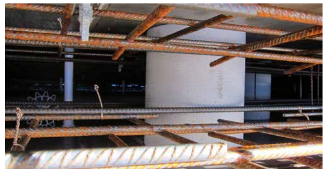
ZVR200/300 in der Schalung fixiert
