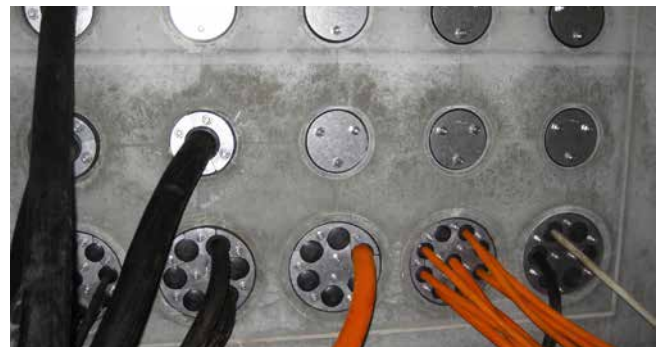
HRD150 SG eingebaut in Faserzementfutterrohre
