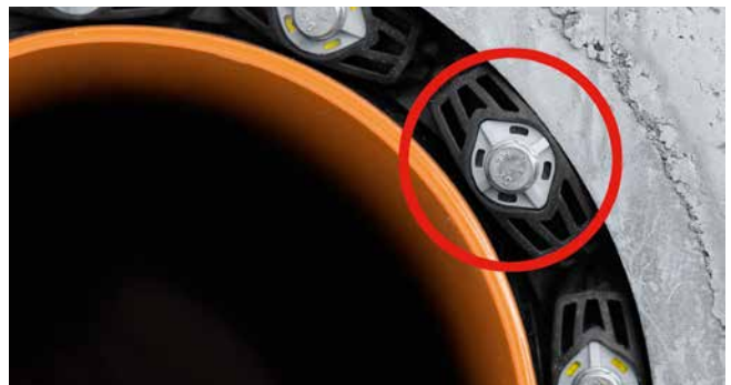
GKD mit einem nicht angezogenen Segment - Montagefehler sofort erkannt
