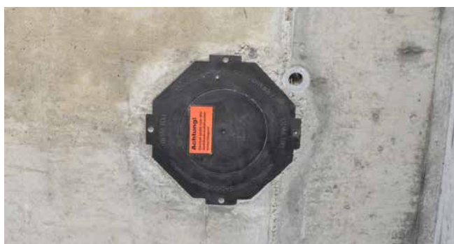
Praktisch beeld van UDM/UDME in betonnen muur
