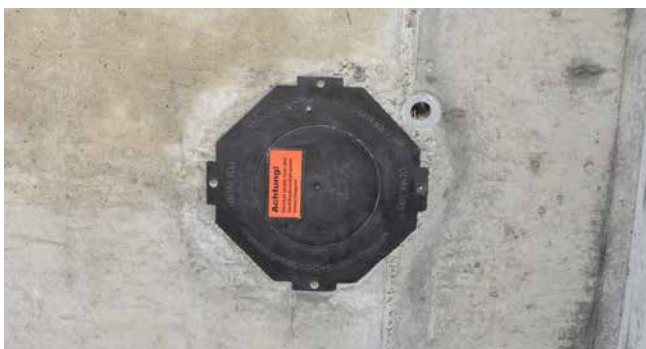
Praktisch beeld van UDM/UDME in betonnen muur
