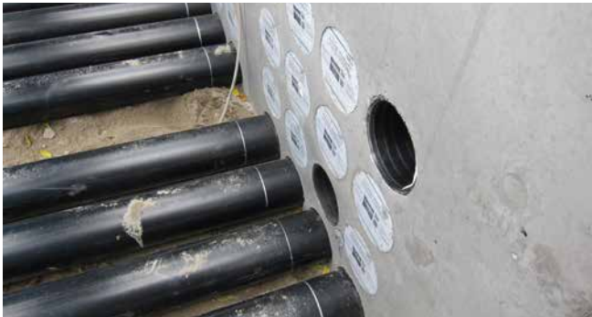
HSI150 GSM Varia als pakket geplaatst
