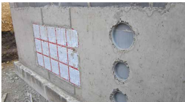
ZVR150 et ZVR200 bétonné près de HSI150
