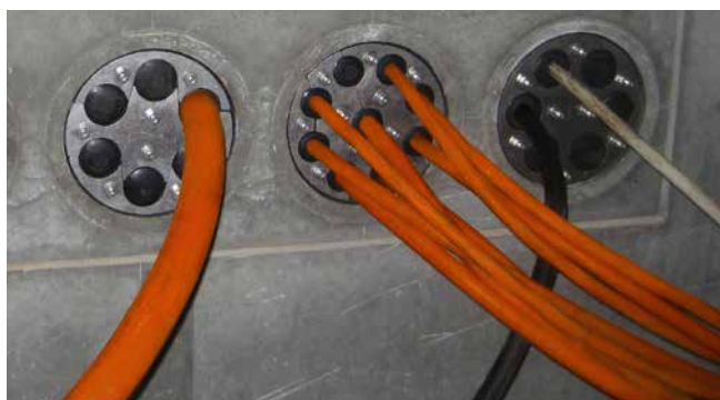
HRD150 SG instalado en casquillos de pared de fibra de cemento
