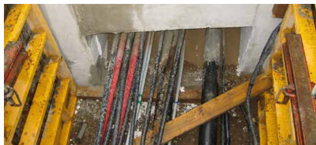
Receso rectangular existente en obra - debe sellarse posteriormente
