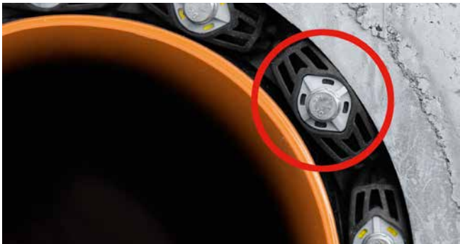
GKD con un segmento no apretado - defecto de montaje identificado inmediatamente
