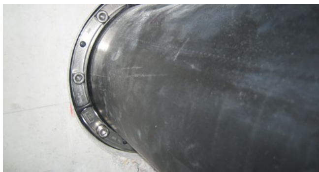
Detailansicht - HSD, Kontrollöffnung und Anzugsreihenfolge der Schrauben
