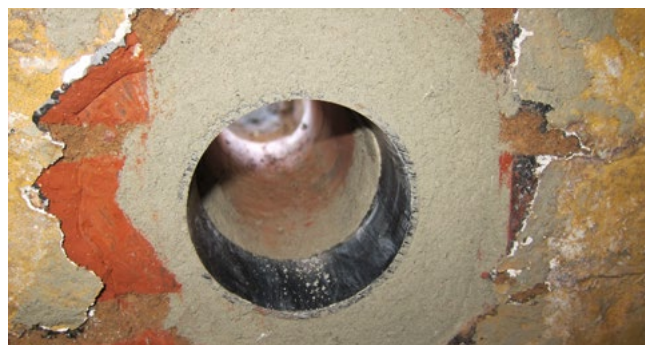
SFR nachträglich im Mauerwerk eingearbeitet
