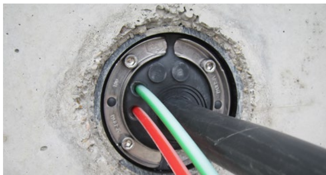
Eingebaute HSD100 EW
