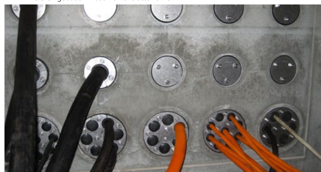
HRD150 SG eingebaut in Faserzementfutterrohre
