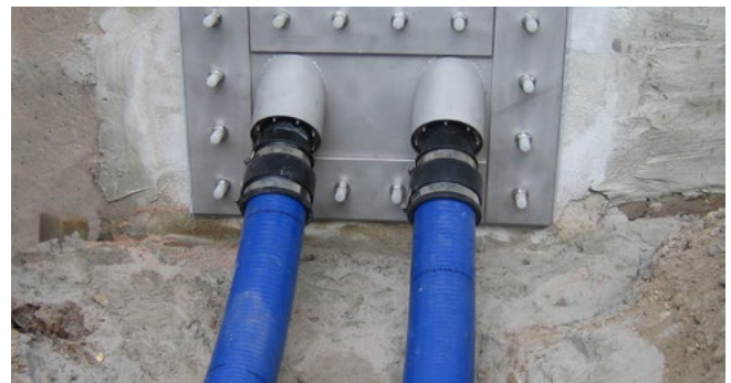
Eingebaute HSD b40
