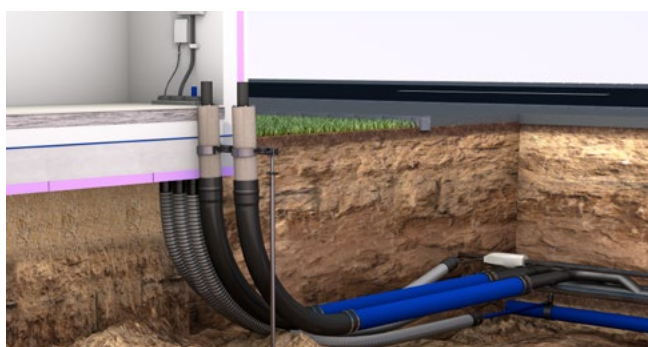
Eingebaute Mehrsparten-Hauseinführung MSH Basic FUBO-FIX RBx mit MSH Basic FUBO SR3, inkl. Aufstellvorrichtung FUBO-FIX AV, Leerrohrsysteme Hateflex14078 MRD/x und Hateflex14110/x und den Sparten Fernwärme, Wasser, Elektro und Kommunikation
