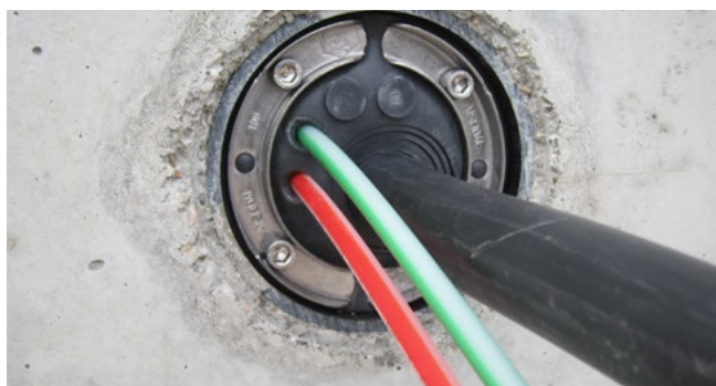
Eingebaute HSD100 EW
