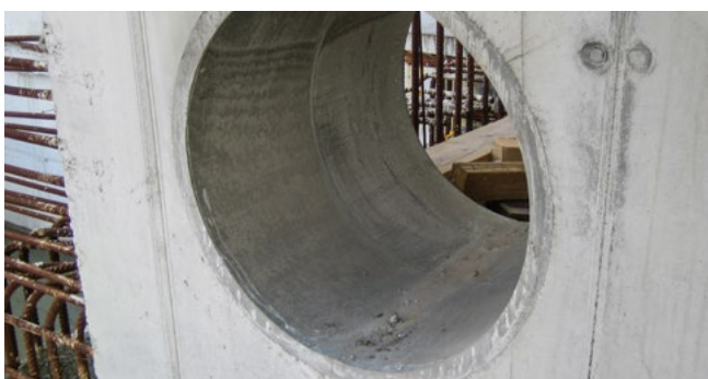
FZR400/300 Einbautort Kläranlage
