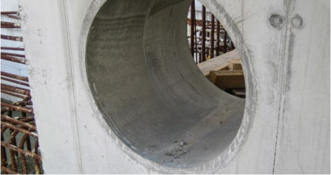
FZR400/300 Einbauort Kläranlage
