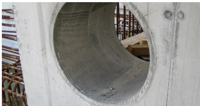
FZR400/300 Einbauort Kläranlage
