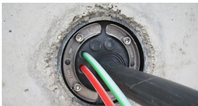
Eingebaute HSD100 EW
