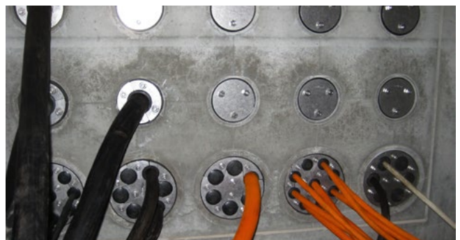
HRD150 SG eingebaut in Faserzementfutterrohre
