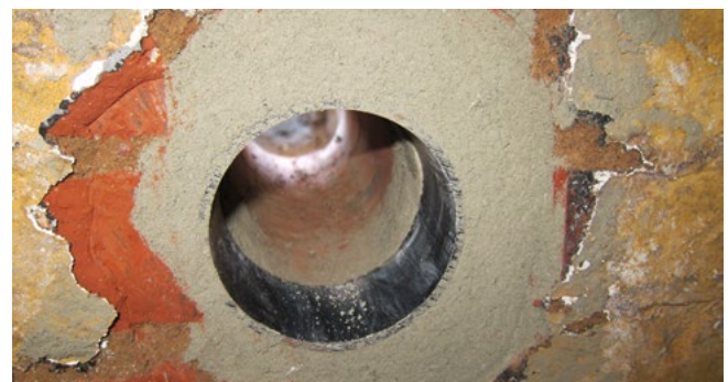
SFR nachträglich im Mauerwerk eingearbeitet
