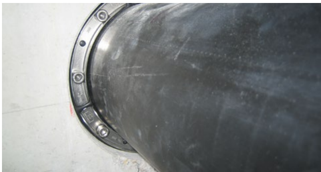
Detailansicht - HSD, Kontrollöffnung und Anzugsreihenfolge der Schrauben
