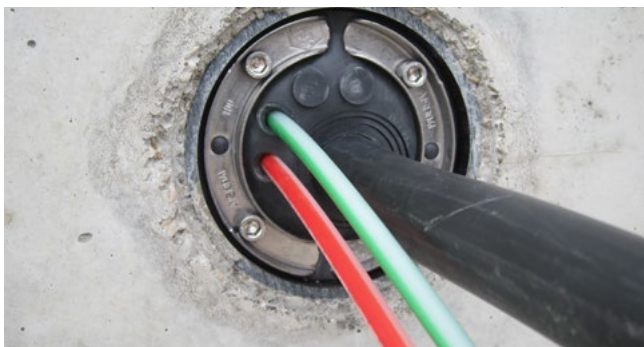
Eingebaute HSD100 EW
