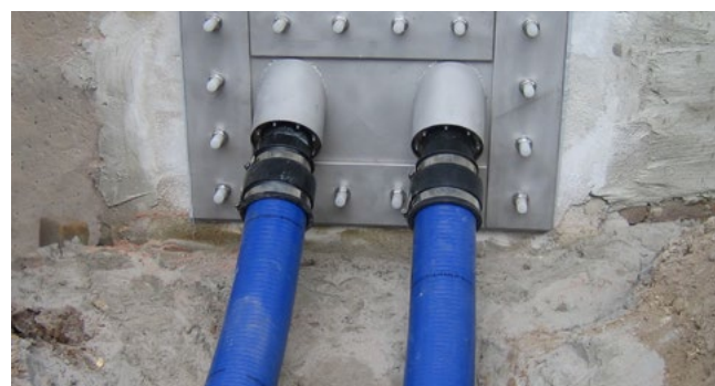
Eingebaute HSD b40
