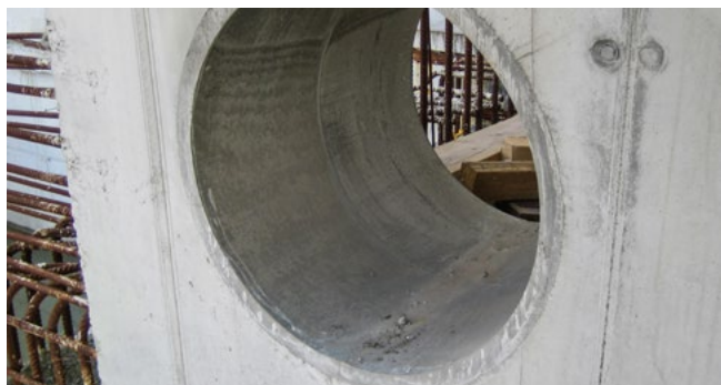
FZR400/300 Einbauort Kläranlage
