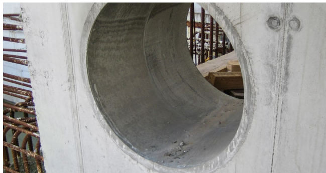
FZR400/300 Einbauort Kläranlage
