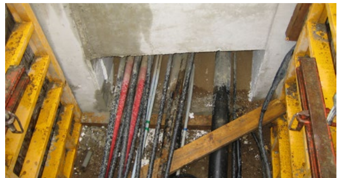
Bauseitig vorhandene rechteckige Aussparung - muss nachträglich abgedichtet werden
