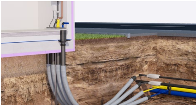
Eingebaute Mehrsparten-Hauseinführung MSH Basic FUBO SR4 EBT mit Dichteinsatz MSH Basic MBK R4, Leerrohrsystem Hateflex14078 MRD/x und den Sparten Wasser, Elektro, Kommunikation und Gas
