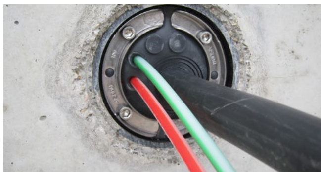
Eingebaute HSD100 EW
