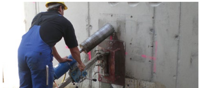
Herstellen von vertikal und horizontal verlaufenden Diamantschrägboreungen für die Aufnahme von HRD-Dichteinsätzen
