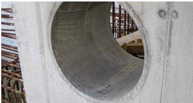
FZR400/300 Einbauort Kläranlage
