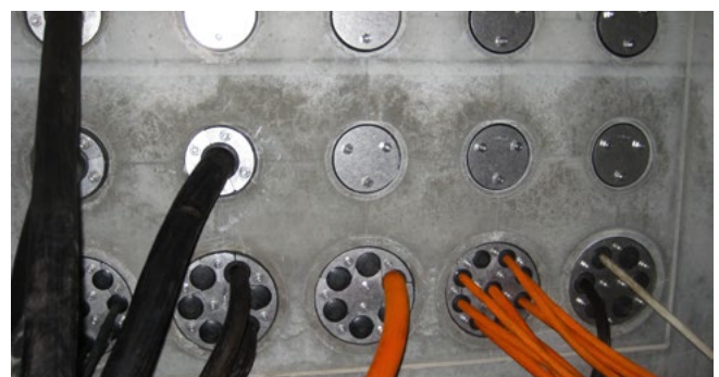
HRD150 SG eingebaut in Faserzementfutterrohre
