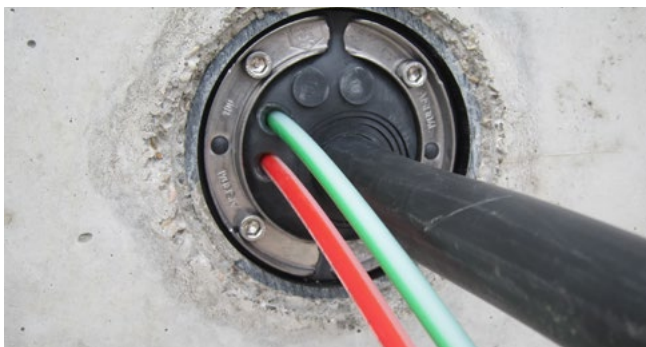
Eingebaute HSD100 EW
