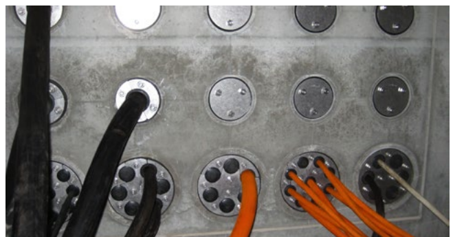
HRD150 SG eingebaut in Faserzementfutterrohre
