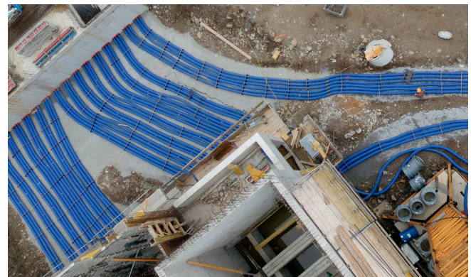
Die Kabelkeller des Umspannwerks werden mit den druckdichten, flexiblen und mechanisch stabilen Kabeleinführungssystemen KES-M150 verbunden.
