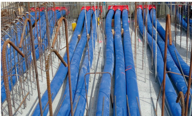
Die Kabeleinführungssysteme KES-M150 verlaufen unter der Bodenplatte und gewährleisten eine sichere Kabelverlegung im überbauten Bereich. Über das Kabelschutzrohrsystem werden die Umspanner aufgestellt.
