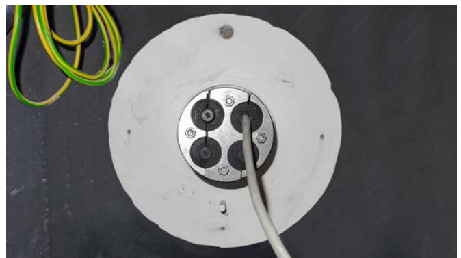
verlegtes Elektrokabel durch Kabelabschottung S90 System HSS zwischen Tribüne und Technikraum
