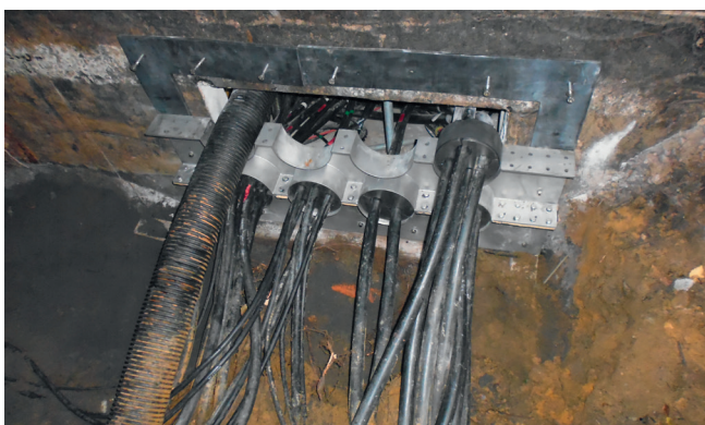
Sektionsvis montering av flänsplattor med långskaftade plugg och skruvar i rostfritt stål.
