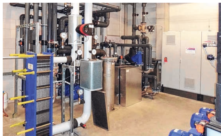
Blick auf die ONI-Kühlwasser-Wärmetauschkaskade mit Schaltschrank zur optimalen Nutzung des Brunnenwassers bei der Hauff-Technik GmbH & Co. KG. (Foto: Hauff-Technik)
