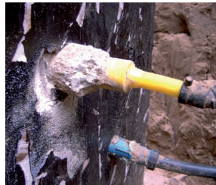
Bild 3: Reklamation im Bereich der Hauseinführungen in Folge einer nicht fachgerechten Wiederherstellung der Kellerabdichtung
